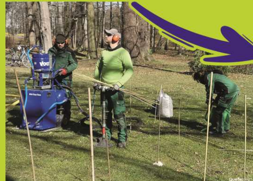
Abb. 4. Die Tiefenbelüftung und -düngung im Wurzelbereich eines großen Solitärbaumes auf der Schlosswiese. Das Bohrmodul (Mitte) erhält Druckluft und Dünger über einen Schlauch aus der Kompressoranlage.
